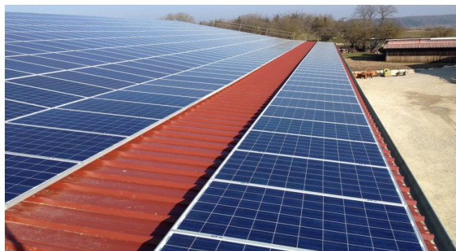
203 kWp Landwirtschaft, Gräfenberg
