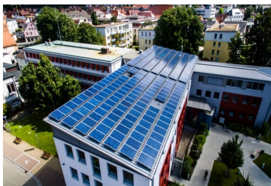
48 kWp Landratsamt Forchheim
