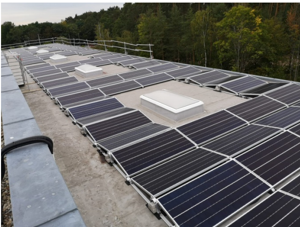
50 kWp Sill Optics GmbH & Co. KG, Wendelstein
