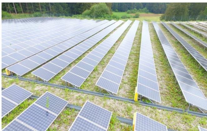
579 kWp Freilandanlage Betzenstein
