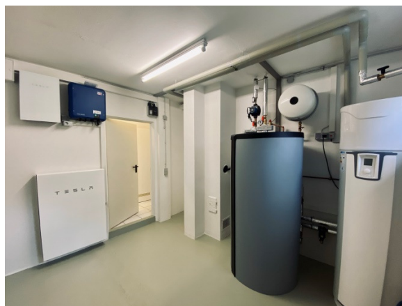
Heizraum inkl. 500 l Panasonic Trinkwasser Wärmepumpe
