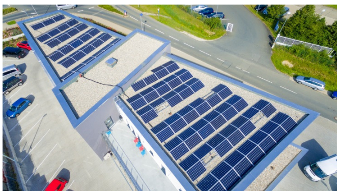
35 kWp Ärztehaus - Eckental
