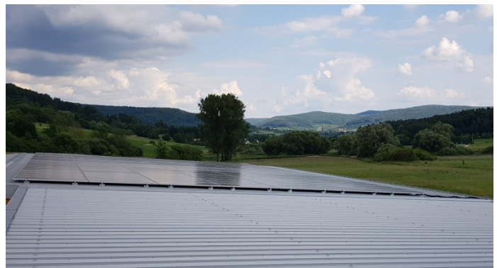
50 kWp die Beerenbauern GmbH & Co. KG, Ebermannstadt
